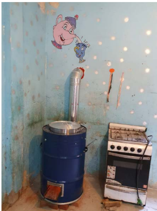
Cocina institucional/colectiva instalada en comedor de La Matanza. Construido en el marco de un proyecto de articulación entre Fundación Acindar, Ingeniería sin Fronteras Argentina, Universidad Nacional de La Matanza y Hacono Estufas. Fuente: Hacono Estufas
